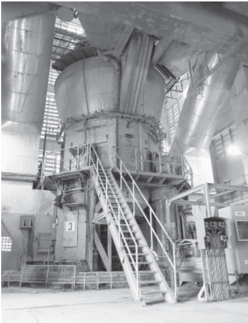
รูปที่ 2-13 หม้อบดวัตถุดิบ (Raw Mill)
