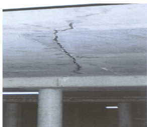
Fig 3 การเกิด Drying Shrinkage Crack ของคอนกรีตโครงสร้างพื้น
