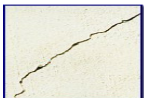
Fig 1 การแตกร้าวเนื่องมาจากการหดตัวแบบแห้ง
