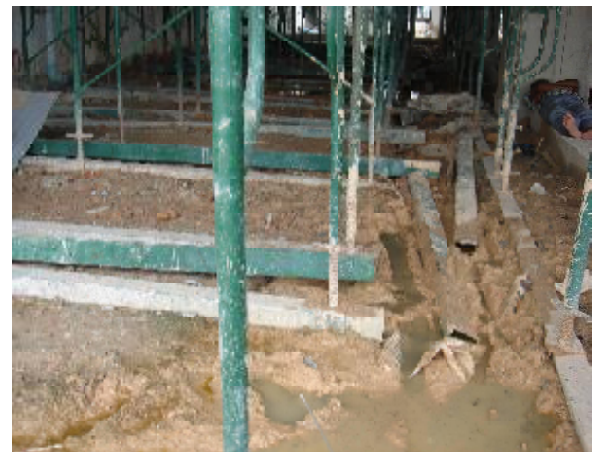
รูปที่ 5 - พื้นดินรองรับค้ำยันที่ไม่เหมาะสม
