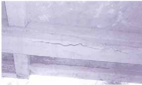
รูปที่ 5 เหล็กเป็นสนิมแล้วรวมตัวกันจนเกิดรอยแตกบริเวณขอบใต้ท้องคาน สังเกตได้ว่ารอยแตกมีลักษณะเป็นเส้นยาวตามแนวคาน เป็นตำแหน่งใกล้เหล็กเสริมและขนานกับเหล็กเสริมในคาน
