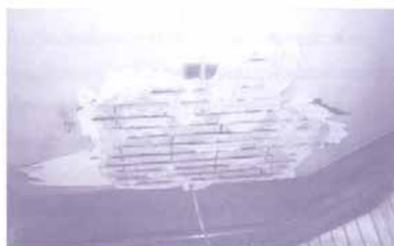
รูปที่ 4 รอยแตกใต้ท้องพื้นจากการที่เหล็กเป็นสนิม เมื่อปล่อยทิ้งไว้วัน คอนกรีตปิดผิวจะหลุดร่วงลง
