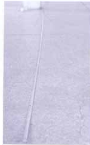
รูปที่ 12 รอยแตกที่พื้นอ้าเกิดเพียงด้านใดด้านหนึ่งแสดงว่ามีฐานรากทรุดตัวไม่เท่ากัน ส่วนมากจะเกิดกับพื้นชั้นใหญ่ เช่น พื้นในโรงงาน
