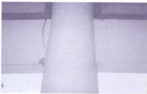
รูปที่ 11 จากรอยแตกในรูปทำให้ทราบว่า ฐานรากด้านขวาและด้านซ้ายทรุดตัวมากกว่าฐานรากที่รองรับเสาต้นนี้
