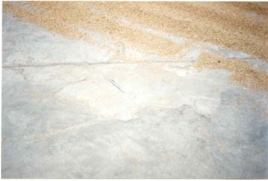
รูปที่ 1 ตัวอย่างคอนกรีตแตกกระเทาะจากช่วงเวลาการลาดปูนขัดมันไม่เหมาะสม
