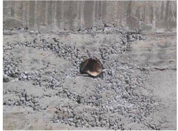
รูปที่ 4 ตัวอย่างคอนกรีตเป็นรูโพรง (Honey Comb)
