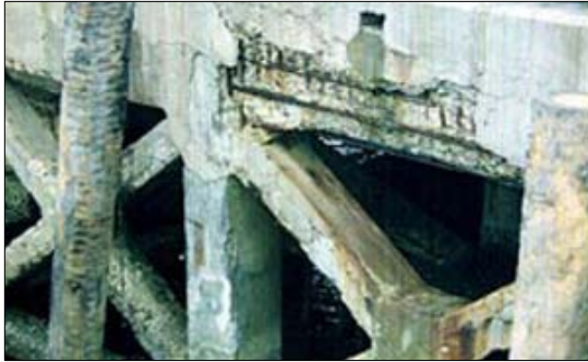
รูปที่ 1 แสดงความเสียหายของคอนกรีตชายฝั่งทะเล
