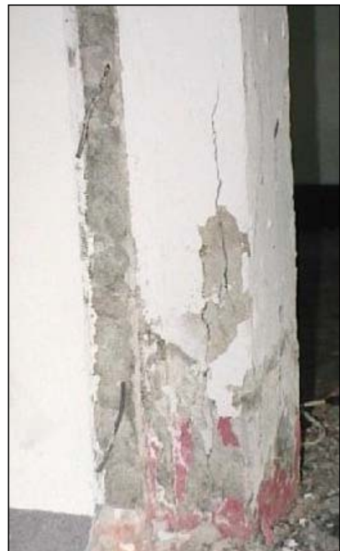
รูปที่ 9 สภาพโครงสร้างเสาชั้นที่ 1 เกิดการแตกร้าว
