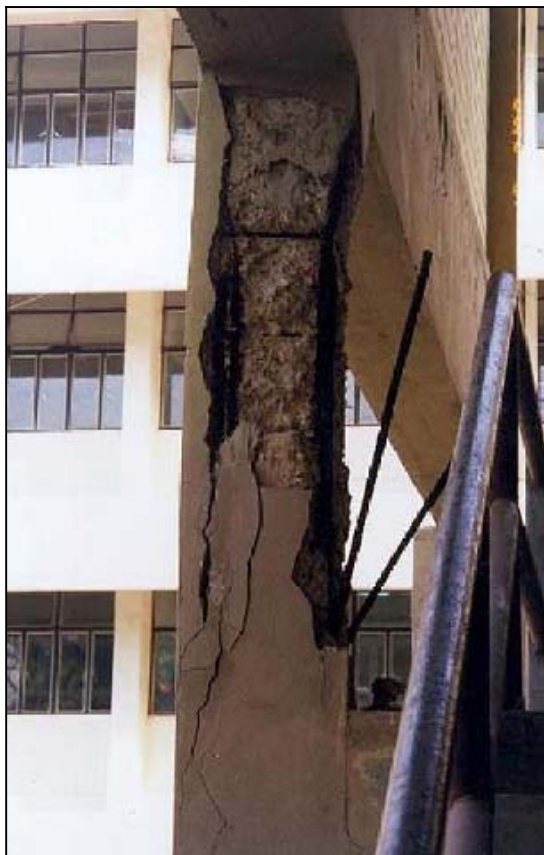
รูปที่ 4 โครงสร้างเสาที่เหล็กเสริมเป็นสนิมแตกออกจากโครงสร้าง
