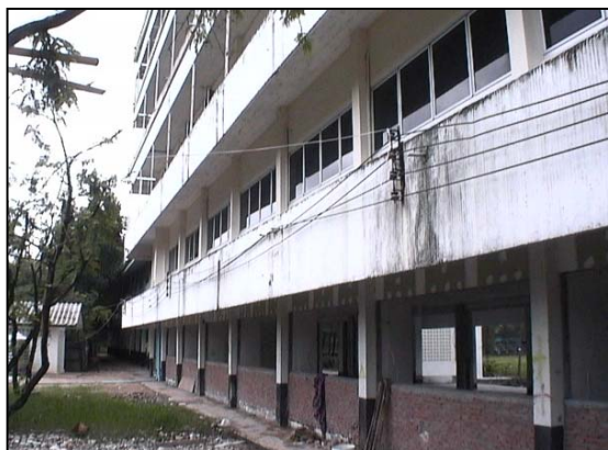
รูปที่ 8 อาคาร 5 ชั้นความเสียหายพบเฉพาะเสาชั้นที่ 1
