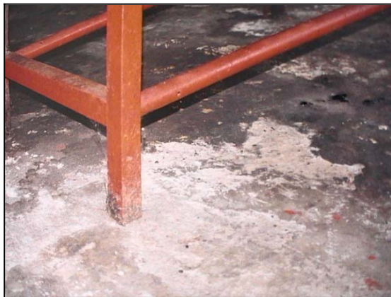
รูปที่ 18 สภาพเหล็กที่สัมผัสกับพื้นที่มีคราบเกลือของอาคารหลังที่ 2
