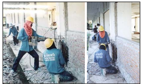
รูปที่ 11 การสกัดคอนกรีตออกเพื่อซ่อมเหล็กเสริม
