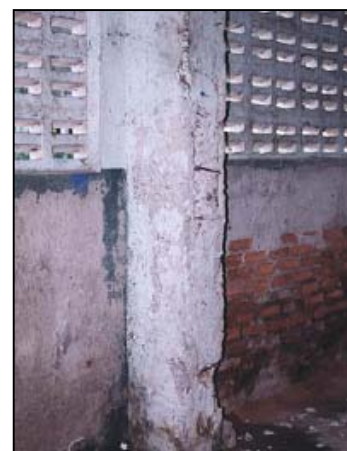
รูปที่ 16 โครงสร้างเสาชั้นที่ 1 ของอาคารหลังที่ 1 ที่ เกิดการแตกร้าวจากการแพร่ของคลอไรด์
