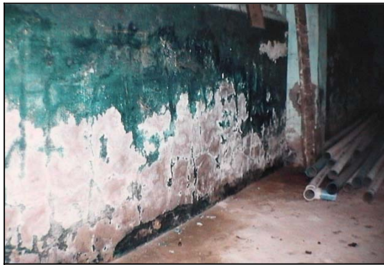
รูปที่ 17 สภาพเกลือที่บริเวณพื้นอาคาร
