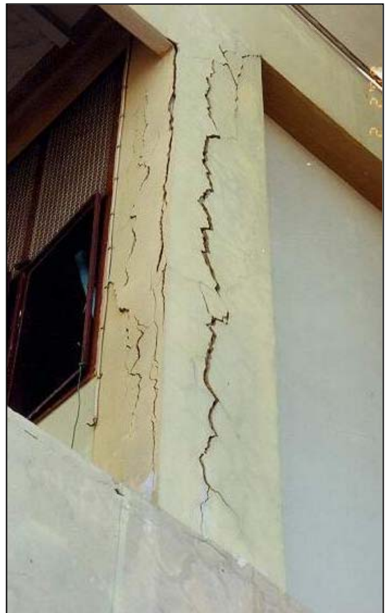
รูปที่ 6 สภาพเสาชั้นที่ 2 ของอาคารเกิดการแตกร้าว
