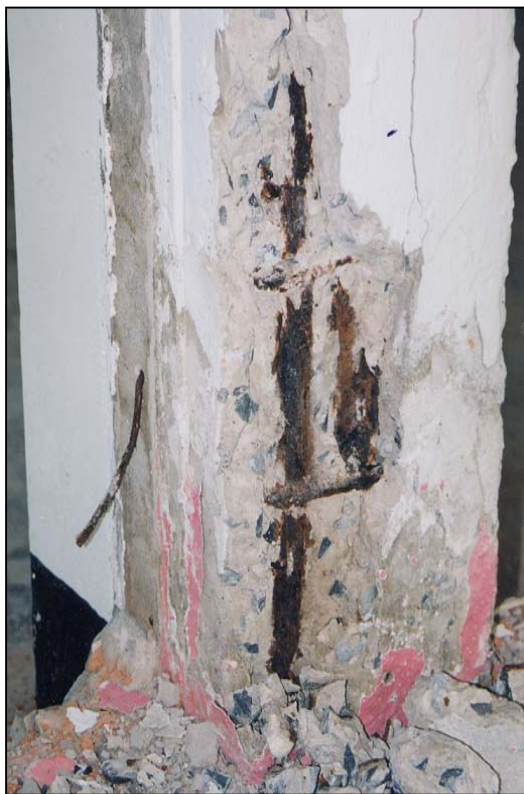
รูปที่ 10 สภาพเหล็กเสริมภายในโครงสร้างเป็นสนิม
