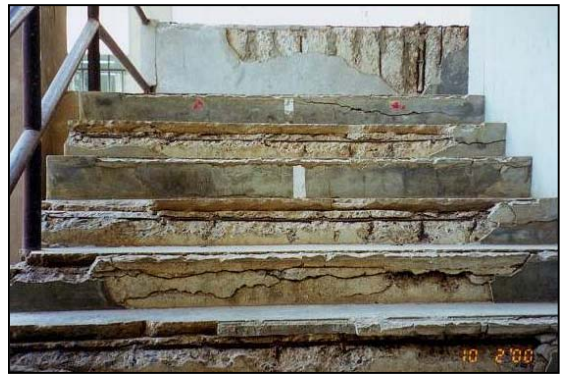
รูปที่ 5 ภาพโครงสร้างบันไดเหล็กเป็นสนิม คอนกรีตหลุดร่อน
